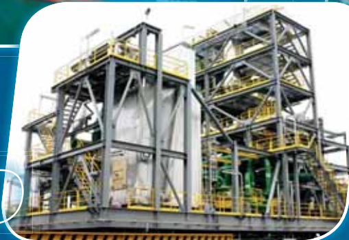
FPSO Marlim Sul (Utility Module)
