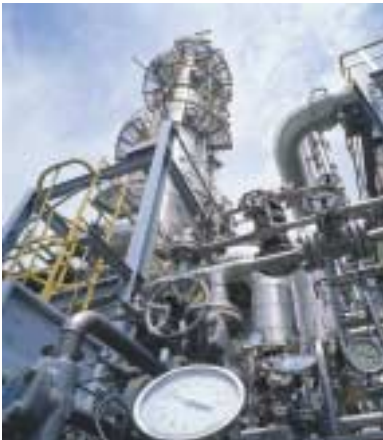
Top/Atas : Online pressure gauge which measures flow Tolok tekanan untuk menyukat aliran gas
