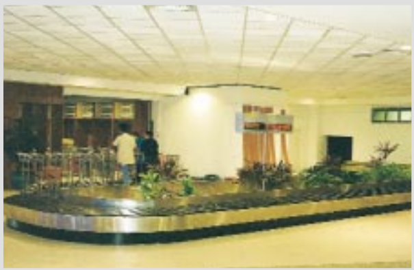
Sistem pembawa bagasi yang telah diperbaharui di lapangan terbang Pulau Pinang yang dipasang oleh Boustead Engineering. Refurbished baggage conveyor system at Penang airport installed by Boustead Engineering.
